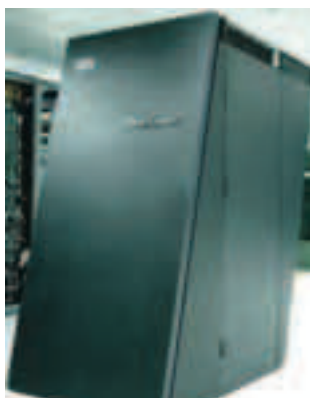
Schrödinger, the national capability computing Blue Gene/P machine installed in HEAnet's national hosting facility. Schrödinger, an gléas ríomhaireachta Blue Gene/P a suiteáladh in áisinteacht náisiúnta afochta HEAnet.
